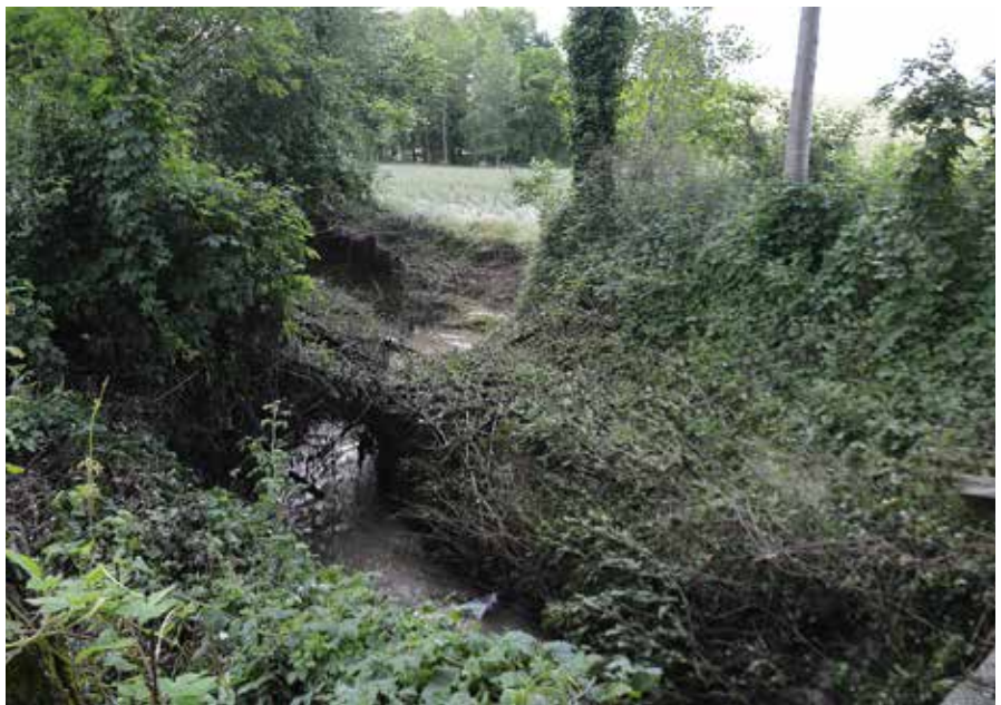
Exemple d'un ruisseau qui a débordé, faute d'entretien, lors des intempéries.
